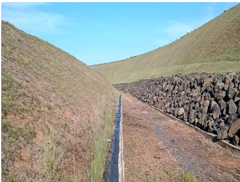
Figura 9. Caneletas de escoamento da PCH Verde 4 (A); Município de Água Clara/MS. Campanha de maio de 2022.
