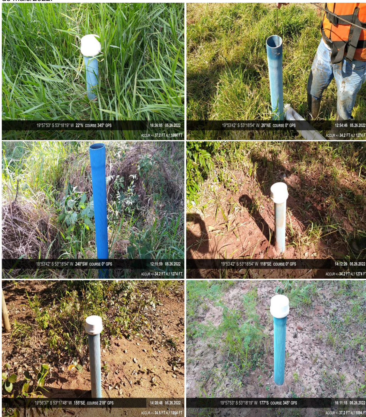
Figura 2 - Poços de monitoramento da PCH Verde 4. Pontos de cima para baixo: P1 a P6. Campanha de maio/2022.
