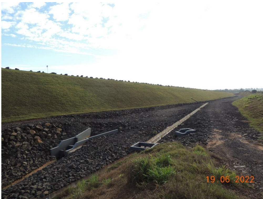
Figura 26 - Área de acesso provisório à jusante encontra-se completamente revestida por grama em leiva plantada.
